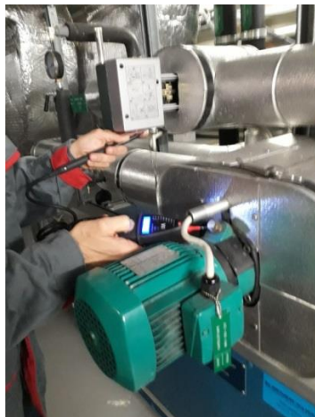
Prüfen des Schutzleiters bei einer HLKS Anlage
