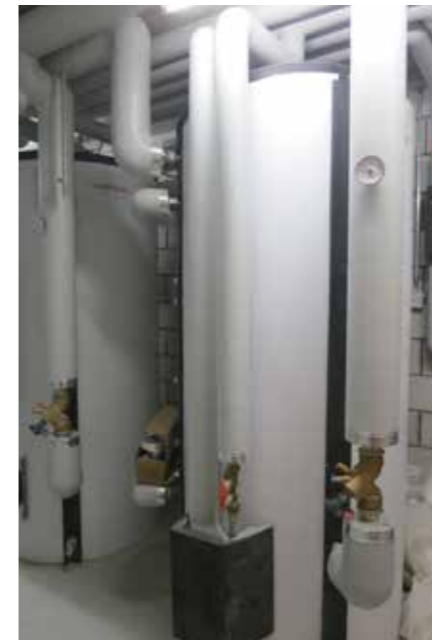
Zwei Energiespeicher von je 910 Litern sorgen dafür, dass immer genügend Warmwasser vorhanden ist.
