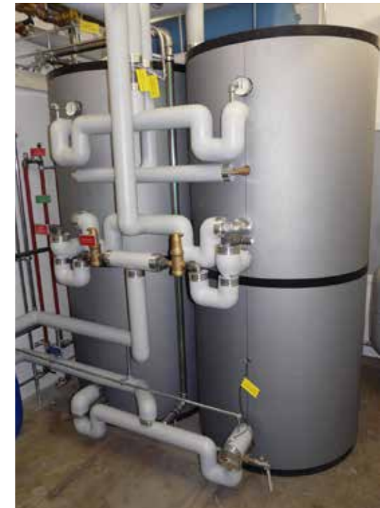
Auch bei diesem Mehrfamilienhaus in Basel setzt man auf Sonnenenergie für das Brauchwasser:
