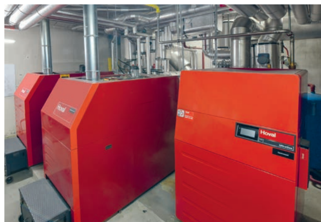
Le système hybride avec les deux chauffages à pellets (à gauche) et le chauffage à gaz (à droite).
