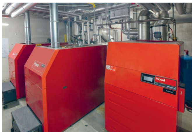
Das hybride Heizsystem mit den beiden Pelletheizungen links und der Gasheizung rechts
