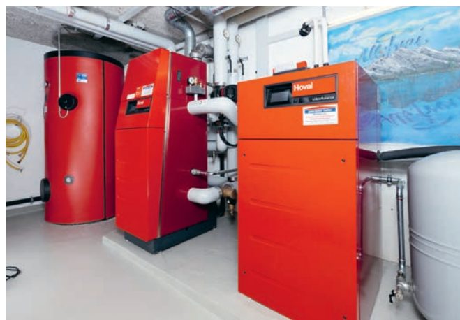
Das hybride Heizsystem mit der Wärmepumpe rechts, der Gasheizung in der Mitte und dem Speicher links
